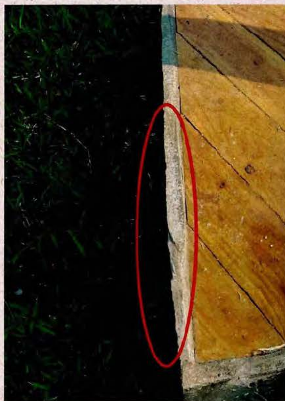
N° 5, revestimiento QM N° 2, no cubre coronación de muro de contención.
