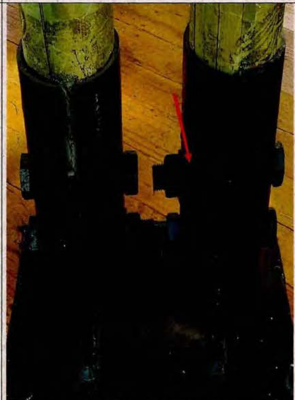
N° 8, pernos de fijación no se encuentran pinchados con soldadura.
