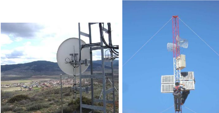
Ejemplo de instalación de repetidores en cerros sin energía eléctrica
