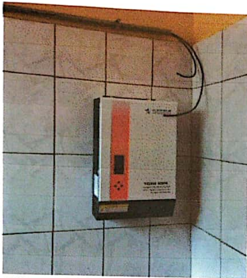
1 INVERSOR DE ENERGIA DE 2KW
