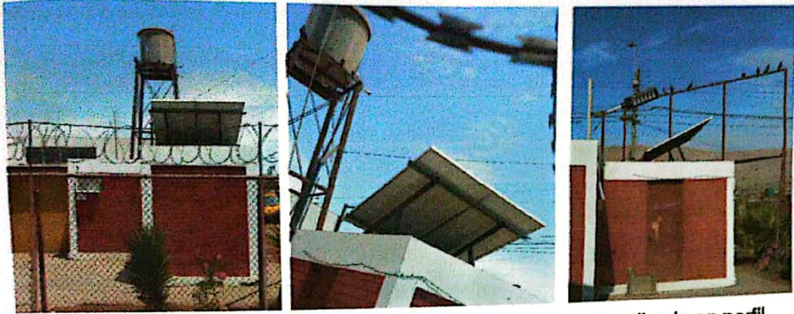
paneles solares instalados en techumbre soportada en un marco realizado en perfil metálico.
