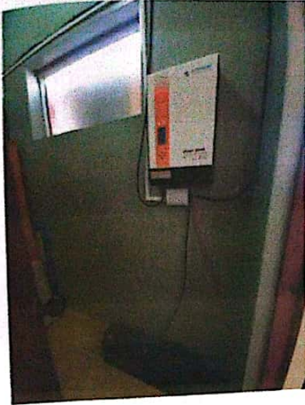
1 INVERSOR DE ENERGIA DE 2KW
