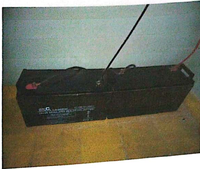
2 BATERIAS DE LITIO DE 2KW 48V
