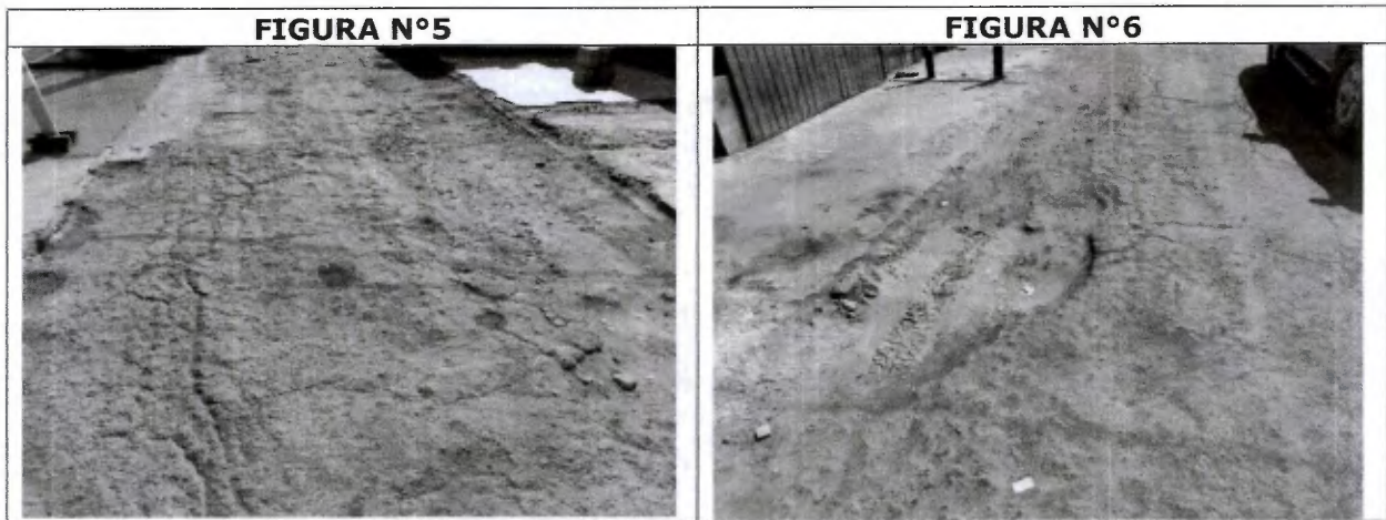
Fotografías N°5 y N°6: Deterioros predominantes sobre pavimento existente, grandes grietas y fisuras, hoyos, desprendimiento de la carpeta entre otros. Pasaje Soldado Tránsito Sánchez (Comandante Ortiz- Exequiel Fuentes)
